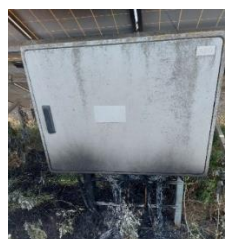
Рис. 2. Последствия пожара на модуле GSB в с. Митяево, п-ов Крым, 06.07.2023 Fig. 2. Consequences of a fire on the GSB module in Mityaev, Crimea, 06.07.2023
