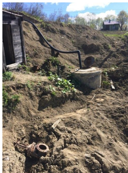
Рис. 4. Повреждения производственной инфраструктуры Fig. 4. Damage to production infrastructure
