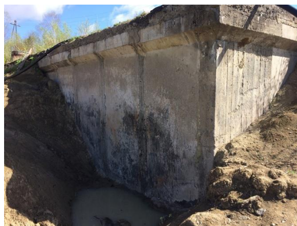
Рис. 6. Разрушение обваловки резервуара Fig. 6. Destruction of the tank embankment
