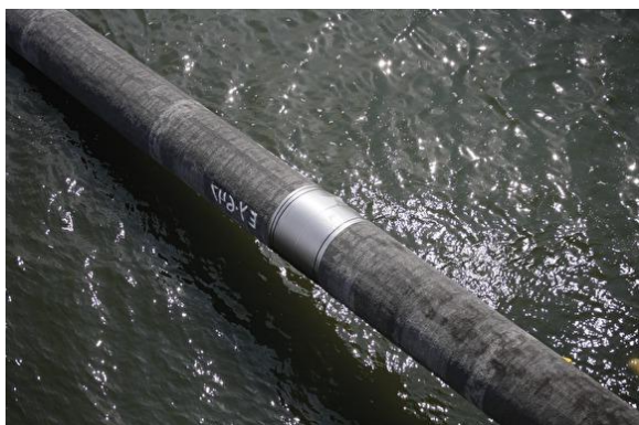
Рис. 1. Размытая оголенная часть подводного участка морского газопровода
