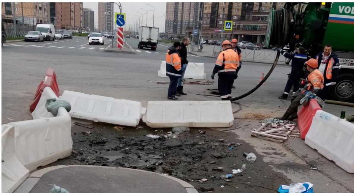
Рис.1. Провал грунта на участке аварии
