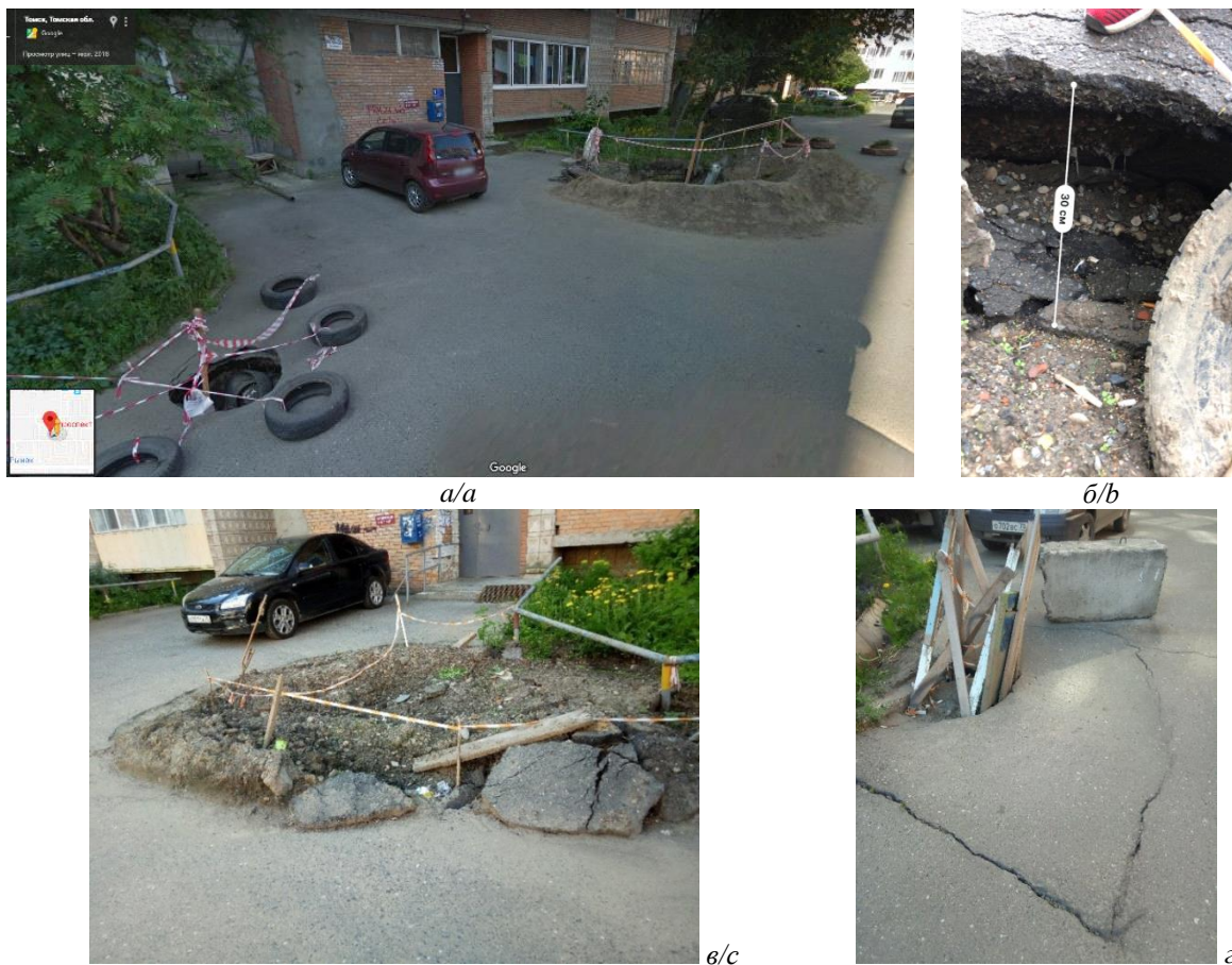
Рис. 2. Провалы возле дома на пр. Фрунзе, 128: а) общий вид двора; б) глубина провала 2015 (фото Небреева А.А. и Кучеренко Ф.И.); в, г) засыпанные провалы 2020 г.
