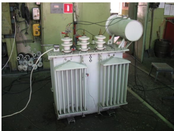
Рис. 1. Внешний вид обследуемого исправного трансформатора
