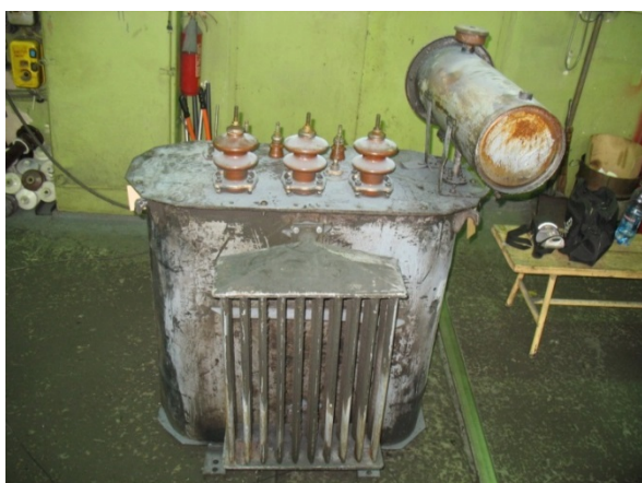
Рис. 2. Внешний вид обследуемого трансформатора с дефектным состоянием обмоток
