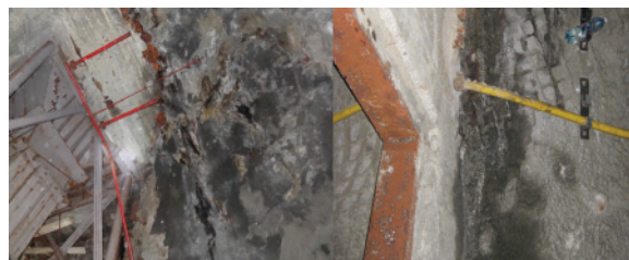
Рис. 1. Водопроявления в выработках кимберлитового рудника «Удачный»
